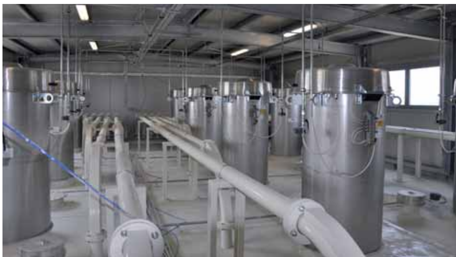
▼ Al di sopra dei silos ci sono questi filtri che impediscono la fuoriuscita di polveri.
