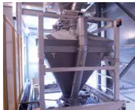
▼ Il carrello posto al di sotto del miscelatore.
