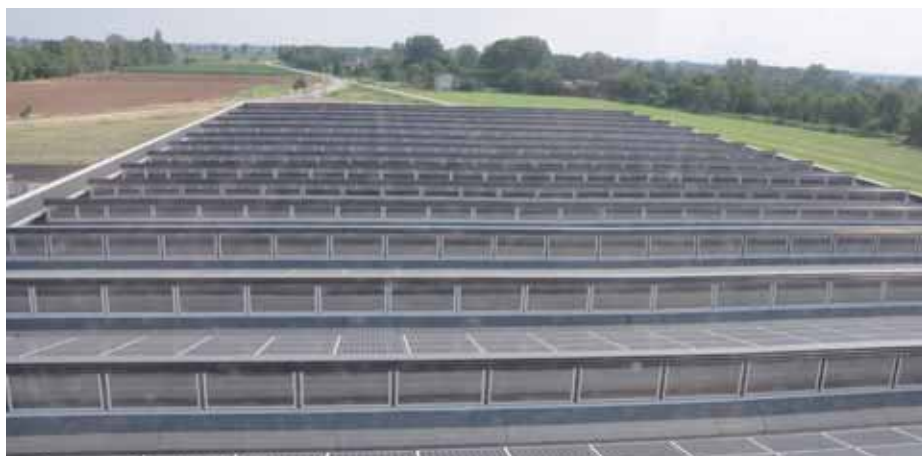
▼ Il tetto dello stabilimento è interamente coperto con pannelli fotovoltaici. IN estate assicurano interamente la quantità di energia elettrica necessaria per il funzionamento degli impianti.
